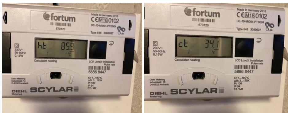
Tillopp och returledningstemperaturer på fjärrvärme sekundär för byggnaden
